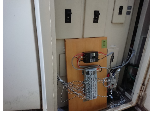
キュービクルに設置
