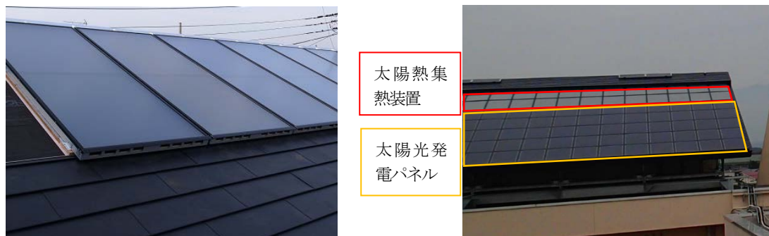
図 5-7 太陽熱集熱装置外観（左：太陽熱集熱装置単独設置，右：太陽光発電パネル併用）
