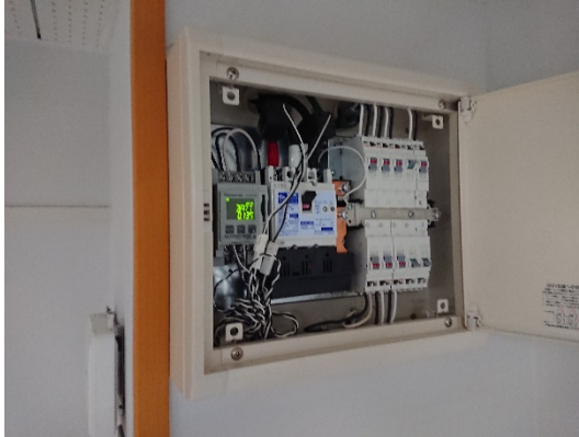
職員室内配電盤に設置
