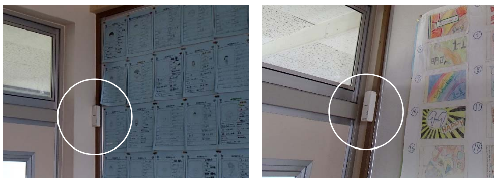
図 5-22 通路側の照度計の設置状況 (左 : CR1, 右 CR3)
