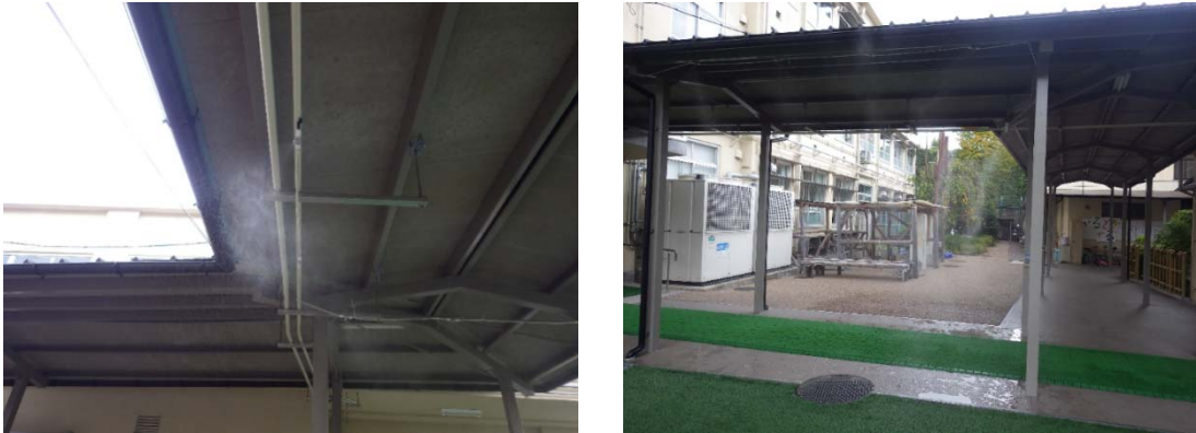
図 5-21 水道直結型ドライミストの稼働状況
