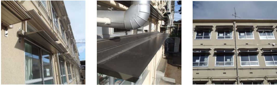
図 6-5 ライトシェルフ設置状況
