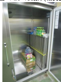
図 4-27 配膳室冷蔵庫(牛乳保管庫)
