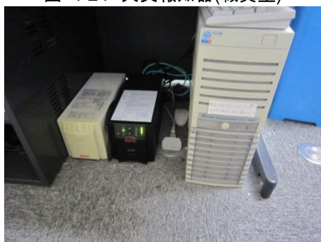
図 4-26 コンピューター室
