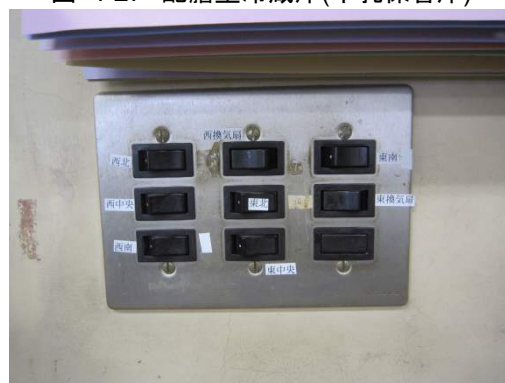
図 4-29 職員室の照明・換気スイッチ
