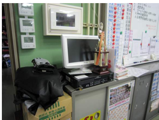
図 2-26 職員室の監視モニター
