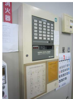
図 2-25 職員室の火災報知器設備
