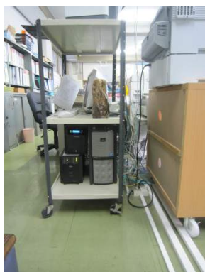
図 2-24 職員室のサーバー
