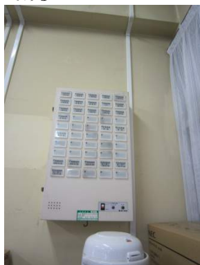
図 4-24 火災報知器(職員室)
