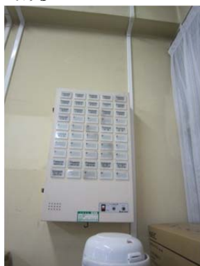
図 4-24 火災報知器(職員室)
