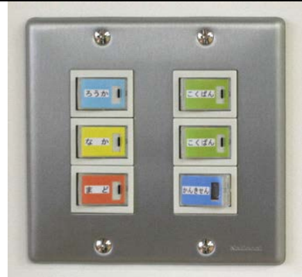
スイッチの工夫(伊予市立翠小学校)
