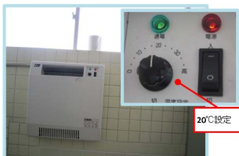
図 2-17 トイレの凍結防止用のパネルヒーター(各トイレに1つ設置されている)
