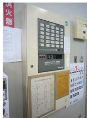
図 2-25 職員室の火災報知器設備
