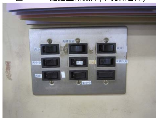
図 4-29 職員室の照明・換気スイッチ
