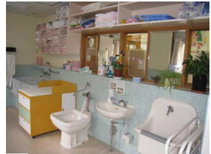
▲沐浴槽：トイレ内に設置（写真奥）
